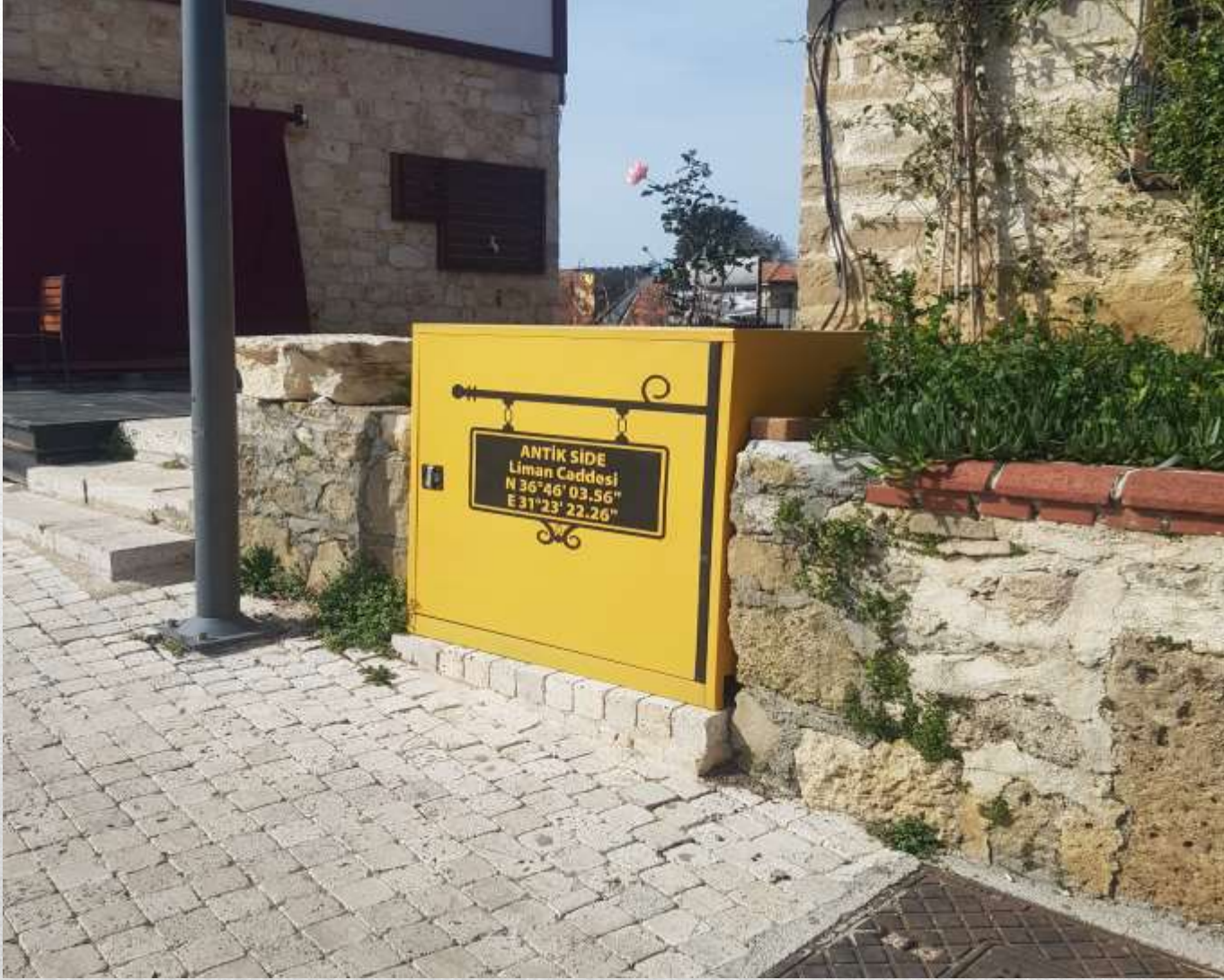
Fotoğraf 6: Antik Side Antik Side Elektrik Panosu
