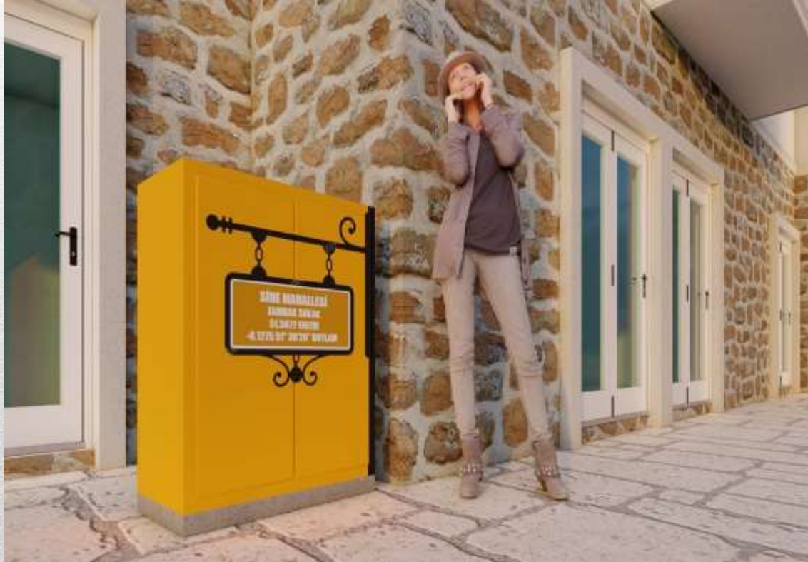
Görsel 69: Antik Side Elektrik Panosu Görsel
